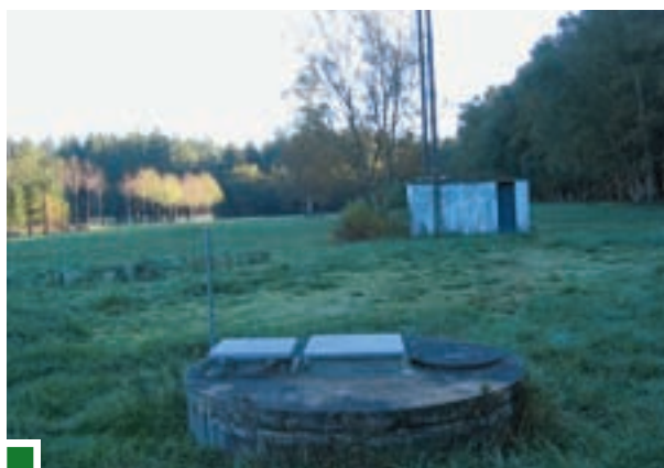
Captage d'eau potable en forêt du Theil (35)
