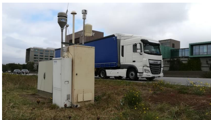
Equipements de mesure installés aux abords de la rocade de Rennes (Porte de Saint Nazaire)
