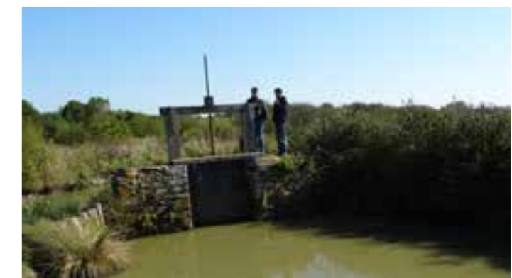
Exemple d'ouvrage pour la gestion des niveaux d'eau des casiers hydrauliques en marais. Composé d'une ventelle s'ouvrant de bas en haut, son ouverture est réglée par des manœuvres réalisées à la main (cl. L. Anras FMA).
