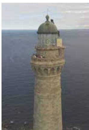
Intervention des techniciens de la DIRM NAMO pour rétablir la protection contre la foudre sur le phare de l'île Vierge
