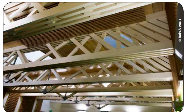
Charpente en peuplier massif - salle polyvalente de Lezennes (59)
