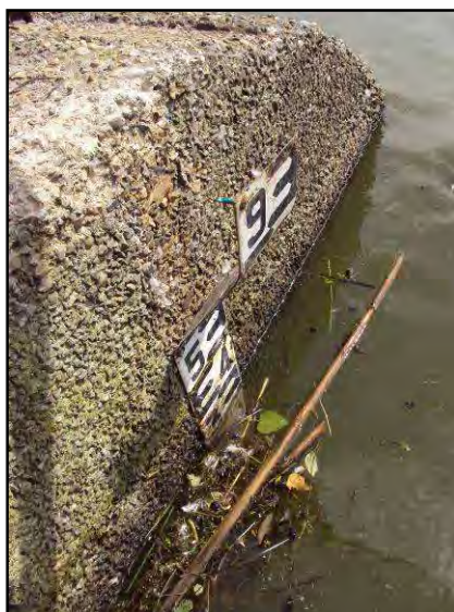
FIGURE 60 : PHOTO DE L'ECHELLE LIMNIMETRIQUE APRES LA CHUTE DE LA PASSERELLE (FISH PASS).
