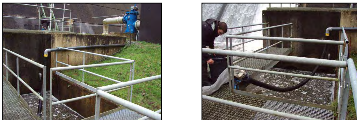
FIGURE 56 : SYSTEME DE PIEGEAGE AU NIVEAU DU SYSTEME DE REJET DES EFFLUENTS DE LAVAGE DU FILTRE DE LA POMPE. (FISH PASS)
