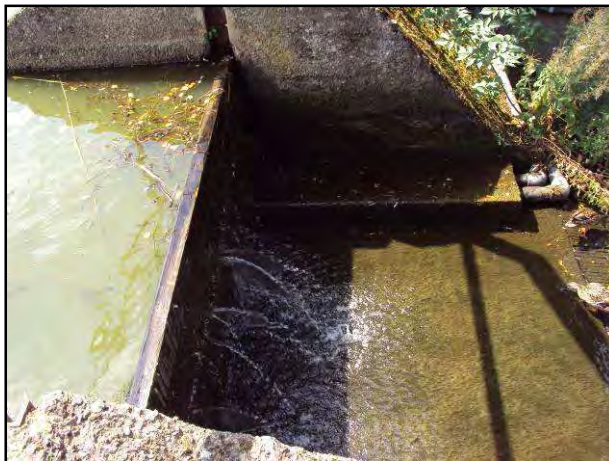
FIGURE 61 : ABSENCE DE SURVERSE A PONT ES OMNES ET FUITES A TRAVERS LES BASTAINGS (FISH PASS).
