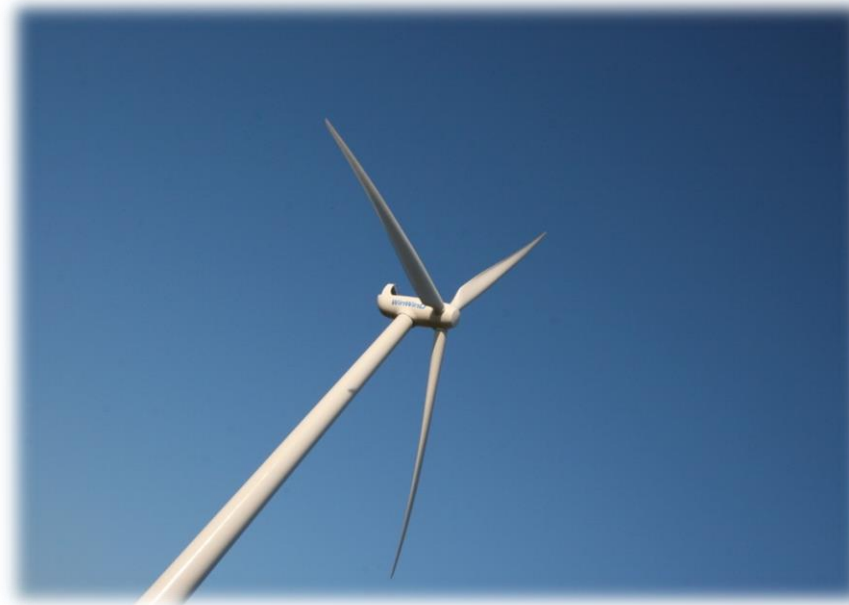
Figure 33 : Eolienne sur le Pays de Redon-Bretagne Sud (Grand-Fougeray)
