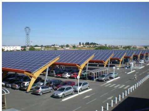
Ombrières photovoltaïques sur le parking du centre commercial E. Leclerc de Saint-Aunès
