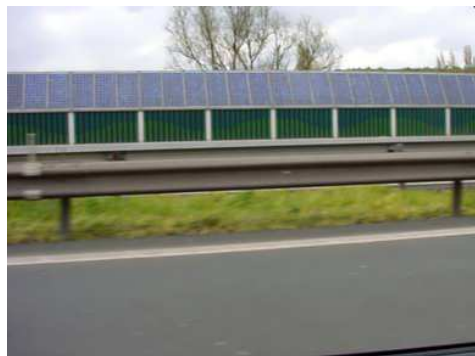
Mur antibruit photovoltaïque sur l'autoroute A 21 près de Lens
