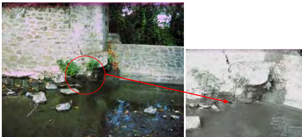
Présence d'une fuite du bras Nord vers le bras Sud à l'aplomb du seuil maçonné
