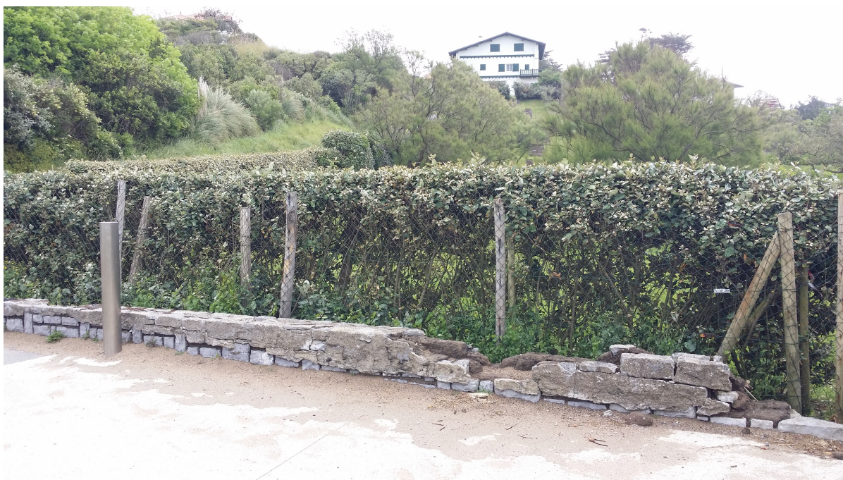
L'ancien mur et le grillage à la place desquels le nouveau mur devait être implanté (CAA de Bordeaux, 14 mars 2017, Commune de Bidart, n°15BX01157).
