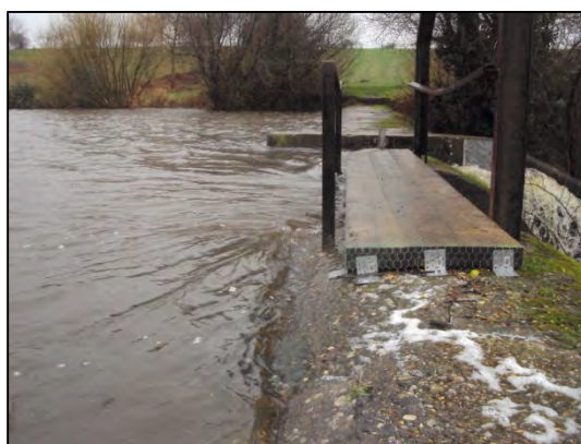
FIGURE 63 : FREMUR A LA LIMITE DE SURVERSE SUR LA DIGUE DE PONT ES OMNES
