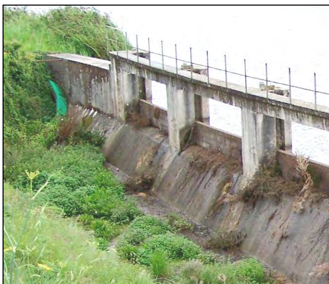
FIGURE 11 : VUE AVAL DU BARRAGE DE PONT AVET AVEC SA PASSE A ANGUILLES (FISH PASS).
