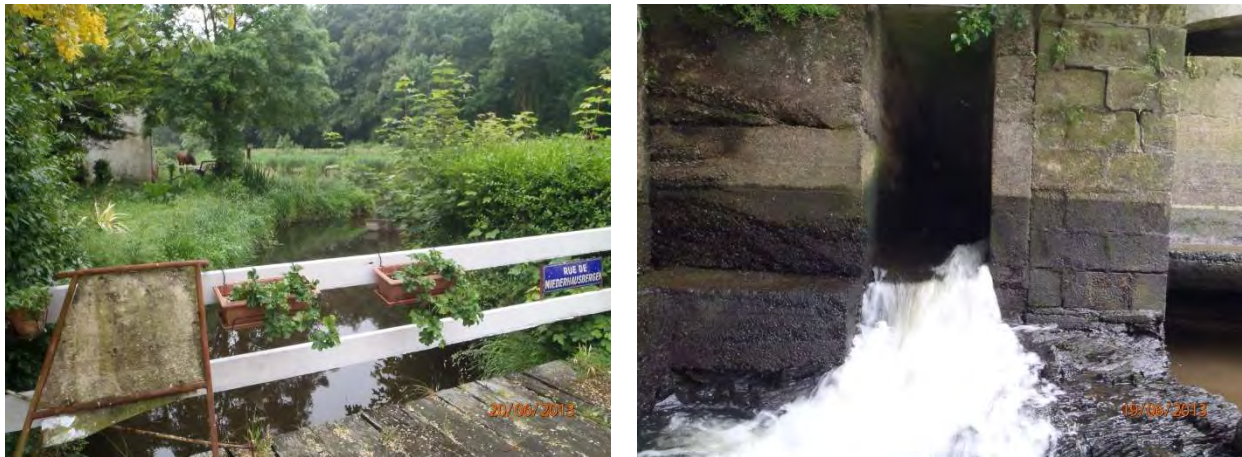
Pertuis usinier droit (prise d'eau et exutoire)
