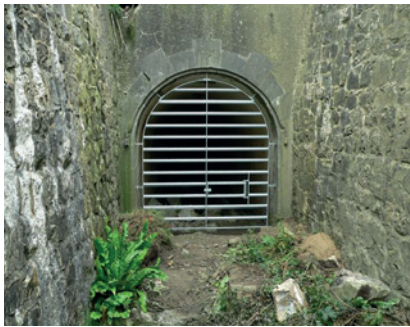
La pose de grilles à barreaux horizontaux permet d'assurer la tranquillité des animaux et la sécurité du public.
