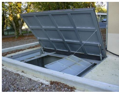
Trappe sur vérins hydrauliques (source Compte.R)
