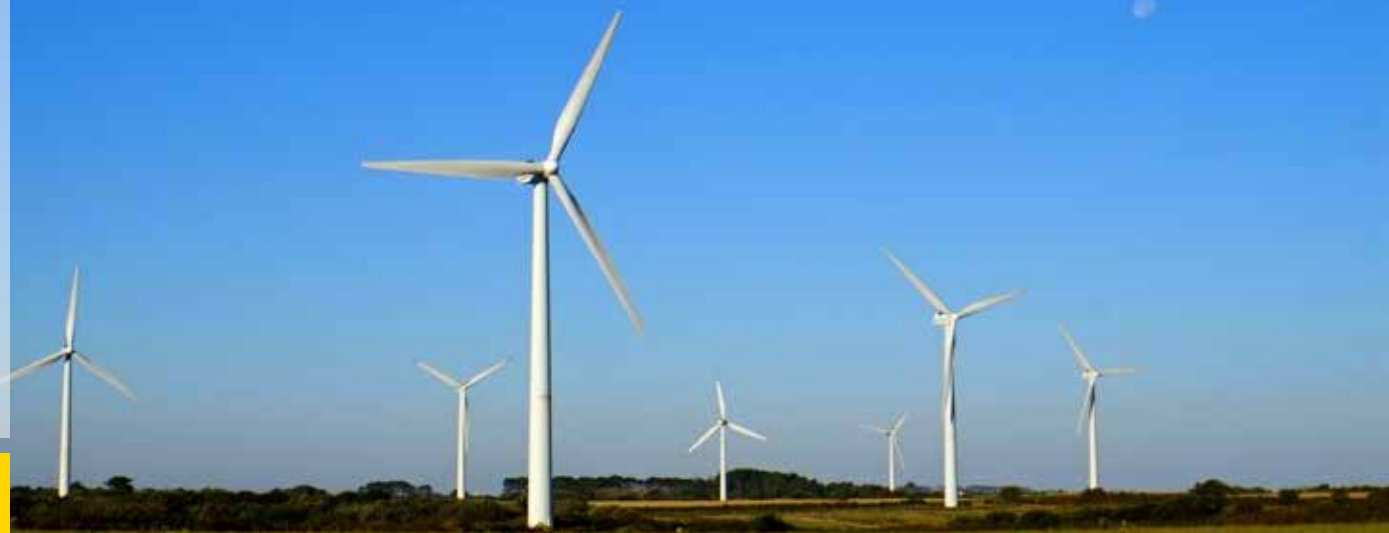
Parc éolien / Goulien
