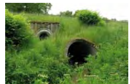
Buse sèche au-dessus de la buse utilisée pour le cours d'eau
