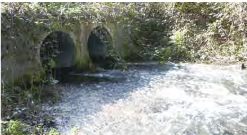
Combinaison de facteurs : tirant d'eau insuffisant, radier béton en aval et vitesse d'écoulement trop élevée
