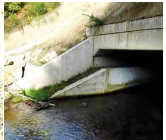
Rampe d'accès non raccordée à la berge
