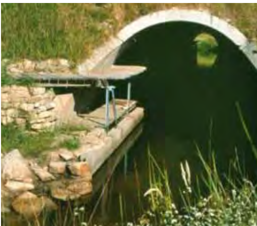
Quelques erreurs fréquentes Erreur de cote obligeant à disposer une passerelle au-dessus de la banquette.
