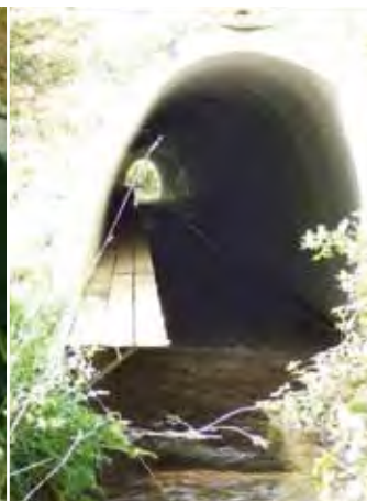
Absence de rampe d'accès
