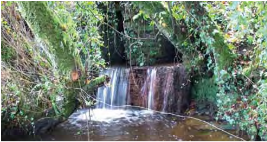
Hauteur de chute trop importante
