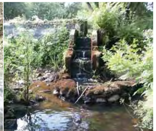
Conception déféctueuse de dispositif de franchissement
