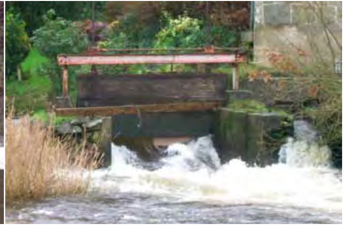
Ouvrage dangereux pour les kayaks (vannage ouvert avec risque d'effet « guillotine »)
