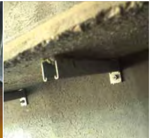
Les équerres risquent de coincer des branchages à l'intérieur de l'ouvrage.
