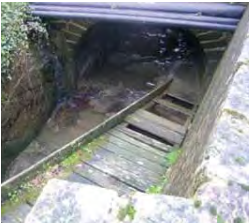
Les passerelles bois sont efficaces mais présentent une vitesse de dégradation importante
