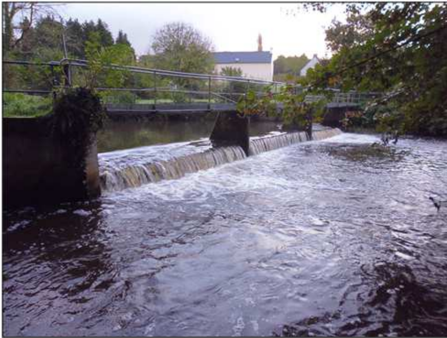
BARRAGE DE KERHAMON : GRILLES ABASSEES ET COLMATEES, FRANCHISSABLES (20/10/2017, source AAPPMA ELORN)
