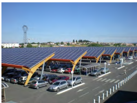
Ombrières photovoltaïques sur le parking du centre commercial E. Leclerc de Saint Aunès
