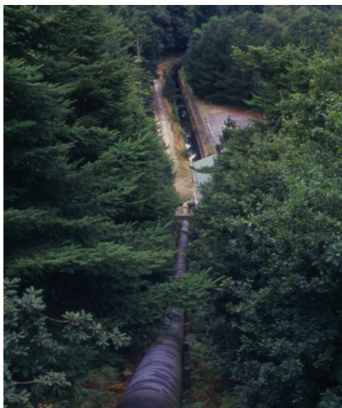
Micro-centrale électrique sur l'Aër.
