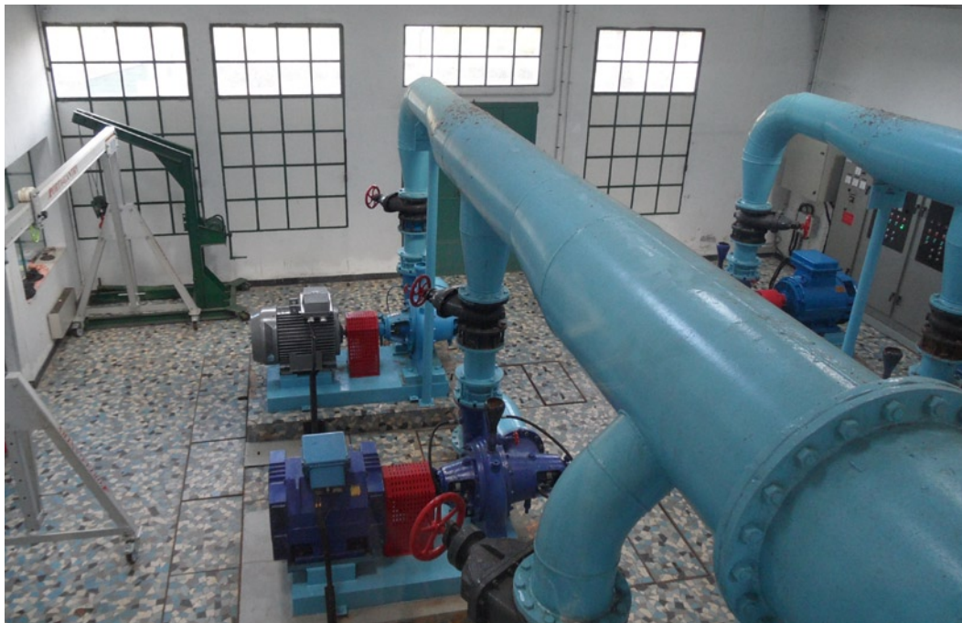
La station de pompage de Keréven, sur le Scorff (à Pont-Scorff), alimente en eau potable une partie du Pays de Lorient.
