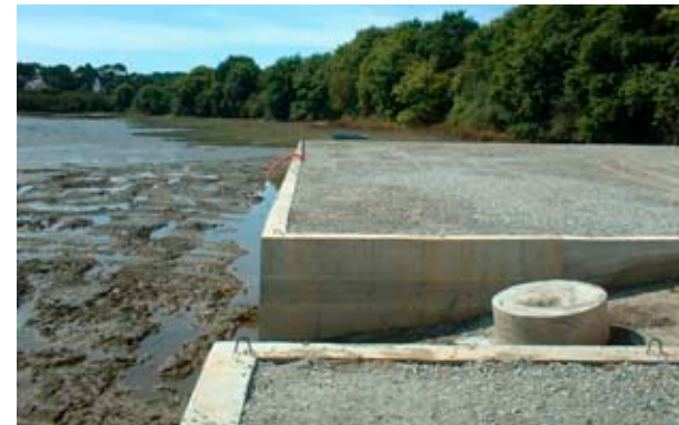
...des efforts doivent être apportés à l'ensemble des ouvrages (matériaux, construction...).
