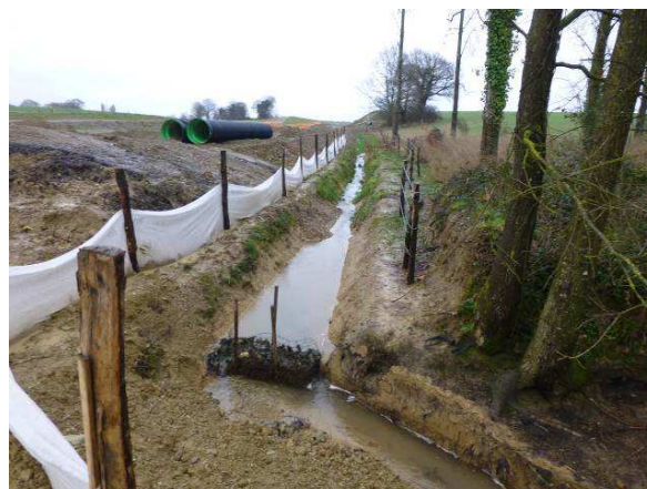
Bâche amphibien au droit de la mare 14 01
