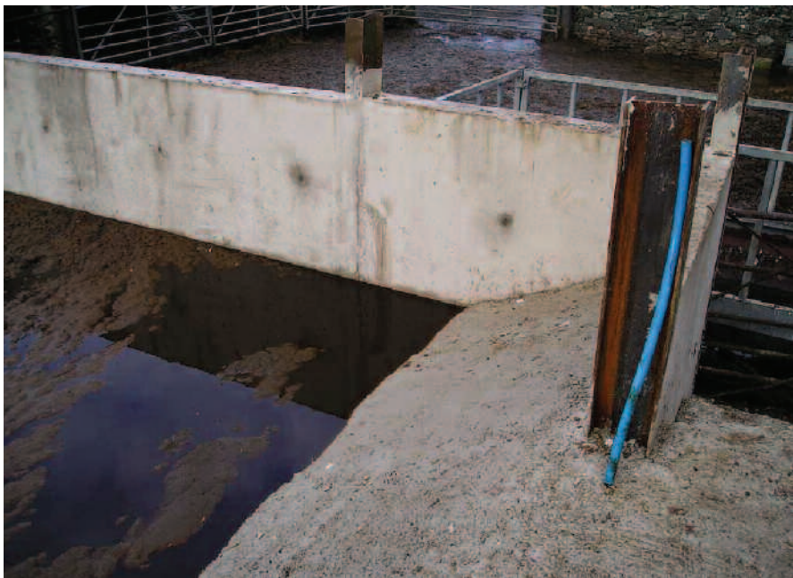
Améliorations d'un conteneur de lisier, Pays de Galles
