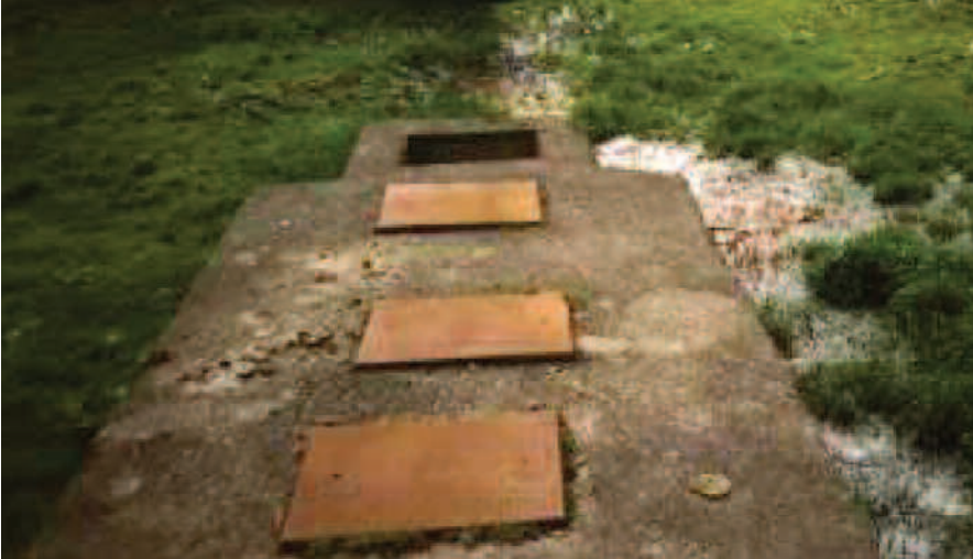
Fausse septique débordant en raison d’une surcharge
