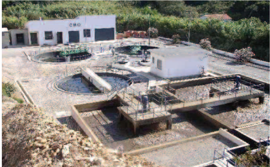
Usine de traitement des eaux et boues activée (traitement secondaire) En amont de Zambujeira Do Mar au Portugal
