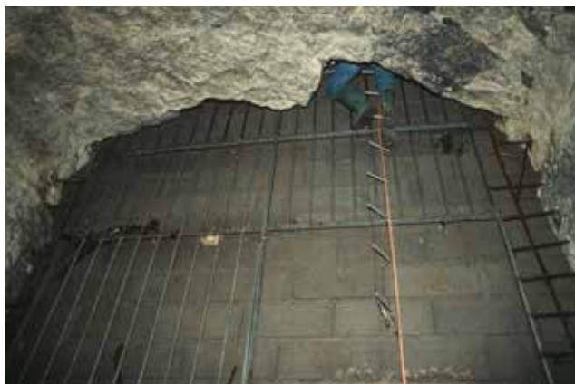
Photo 2 Mur en parpaing et grille vandalisée (vue intérieure)
