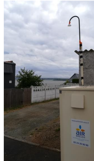
Figure 4 : Cabine abritant l'analyseur H 2 S
