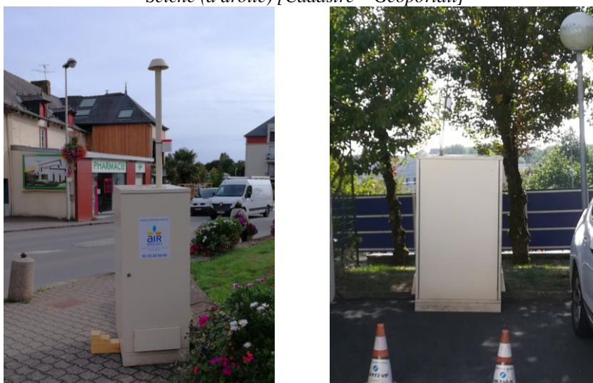
Figure 22 : Points de mesures automatiques à G6 Gévezé (à gauche) et V1 Vern-sur-Seiche (à droite)
