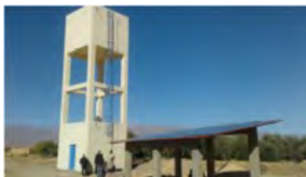
intervention au Maroc Forage et réservoir fonctionnant avec un pompage solaire © Association L'Orme
