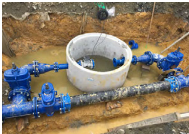
Compteur de sectorisation installé sur un by-pass
