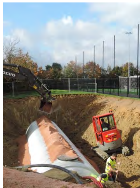
Installation d'une cuve de récupération d'eau de pluie financée par le fonds ECODO Le Rheu - Octobre 2017
