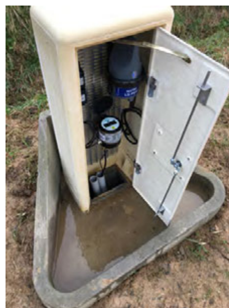
Compteur de séparation de réseaux posé à Chevaigné Février 2017
