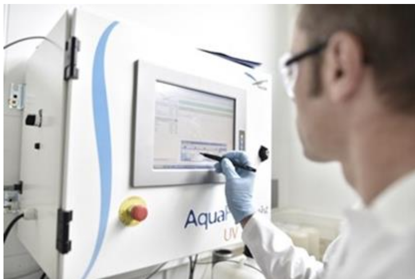
Usine de Mezières-sur-Couesnon Analyseur en ligne pour suivi en continu de la qualité de l'eau Copyright - SAFEGE - Franck DUNOUAU
