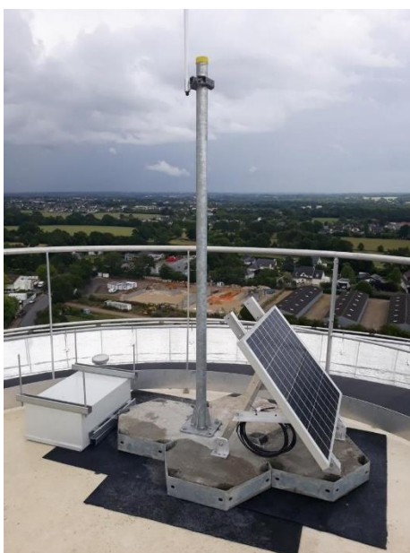
Installation antennes LORA – réservoir de Bruz
