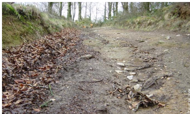
Erosion du sol sur un chemin de terre
