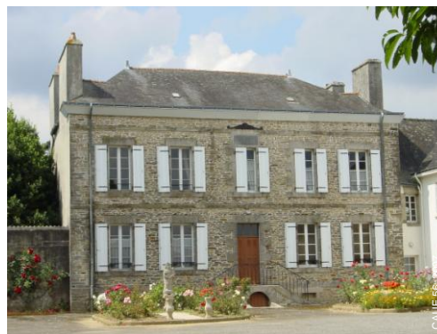
⑤ Presbytère en Moréac Gros œuvre : murs en pierres de schiste ou grès schisteux ; encadrements en granite taillé
