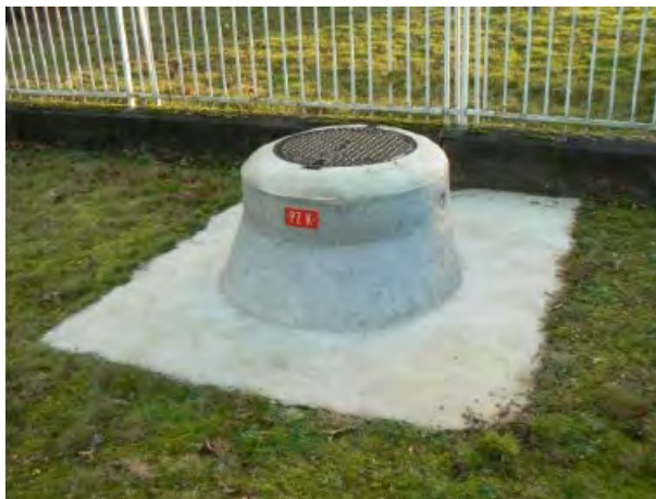
Piezomètre situé sur la nappe tertiaire Site industriel de PSA - La Janais © LogHydro
