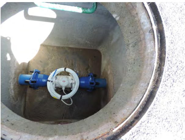
Compteur de sectorisation posé à Rennes Juillet 2016
