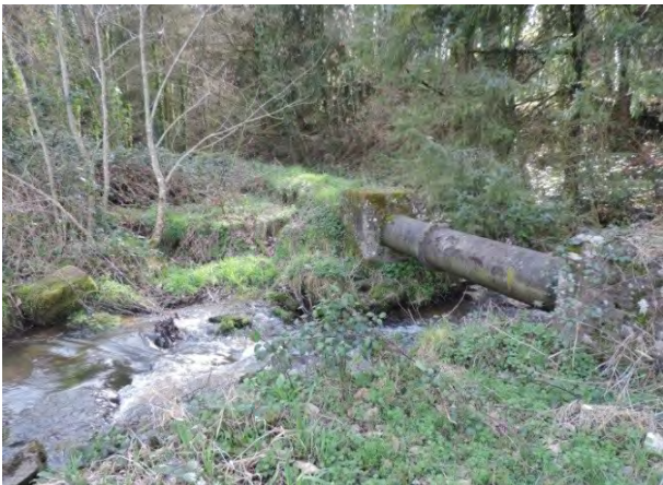
Canalisation d'eau brute située en amont de l'usine de Mézières-sur-Couesnon Traversée de la Minette
