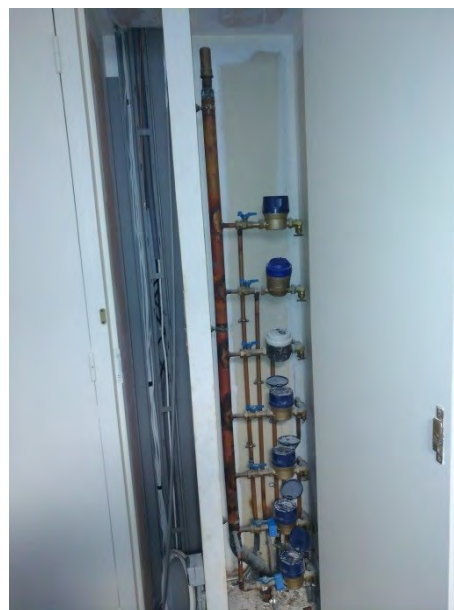
Compteurs individuels publics d'eau potable installés dans un immeuble collectif rennais © SPL Eau du Bassin Rennais
