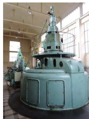
Vue des alternateurs de la centrale hydroélectrique de Rophémel
