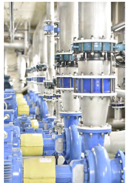
Usine de Mézières-sur-Couesnon Salle de pompage © SAFEGE - Franck DUNOUAU Photographe
