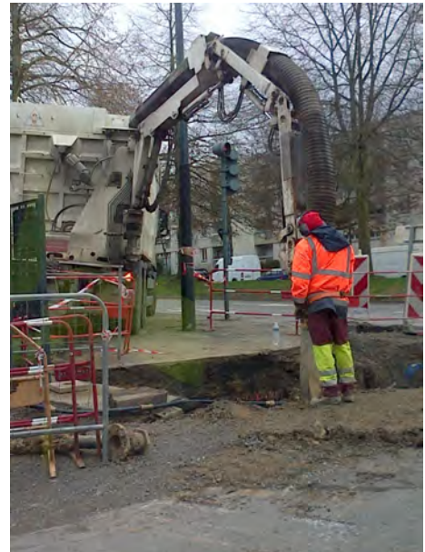
Renouvellement de branchements Terrassement à l'aide d'une aspiratrice Avenue de la Vistule - Rennes Février 2016
