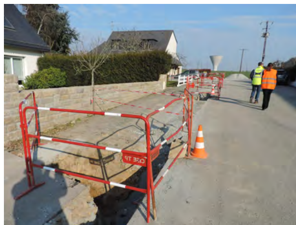
Travaux de renouvellement de canalisations et branchements Rue du Parc - Cesson-Sévigné Mars 2016
