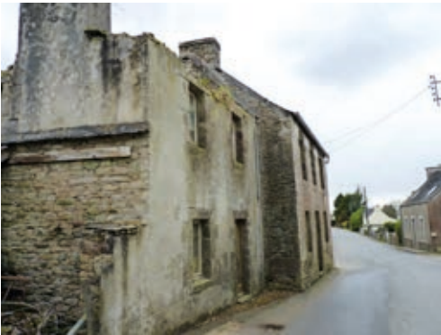
Un exemple de bâtiment abandonné en ruine dans un centre bourg (UP9, avril 2012).
