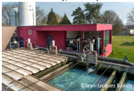
La station de traitement des eaux de Kernisy, à Quimper
